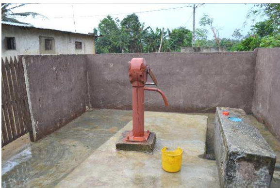
Site n°2 de Babadouguou : pompe en parfait état
